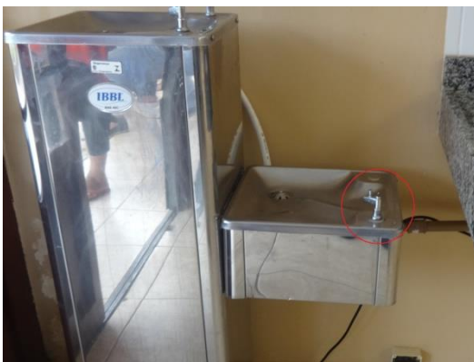
Bebedouro público com botão de acionamento danificado.
