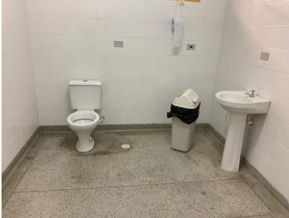
Banheiro, projetado como acessível, não adaptado
