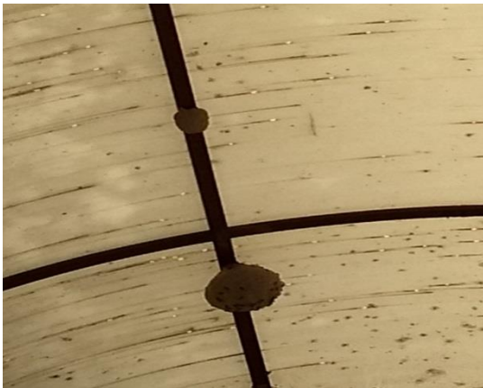
Infiltração/vespeiro no teto da esquadria (interno) de área de luz
