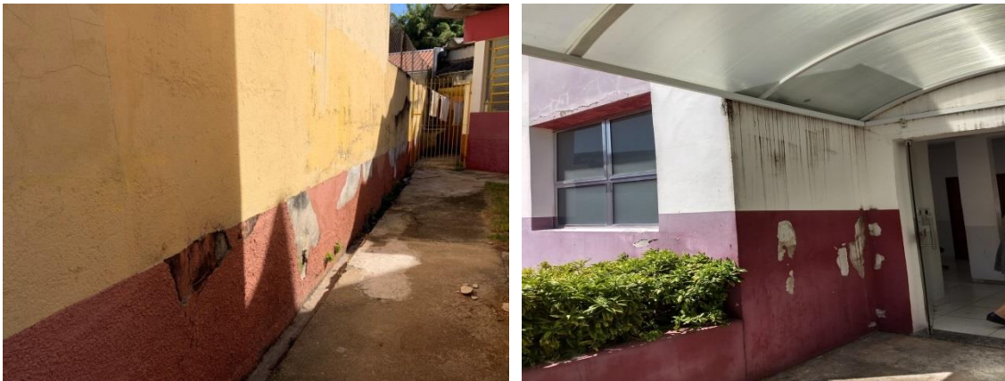
Pintura deteriorada / infiltração / mofo
