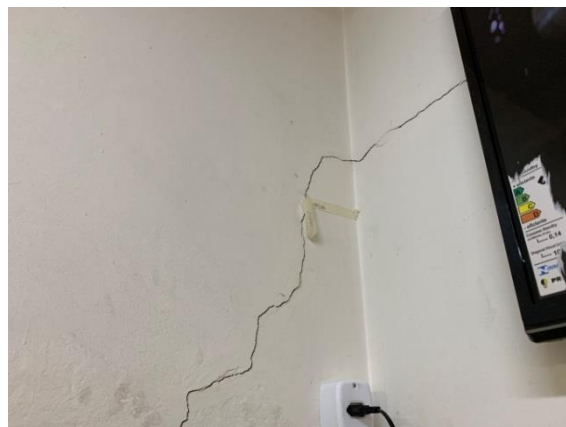
Rachadura detectada há pelo menos 3 anos
