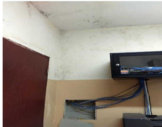
Mofo/installação inadequada de fiação de rede.
