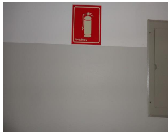
Ausência de extintor de incêndio.
