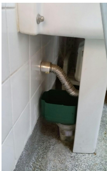
sifão com vazamento
