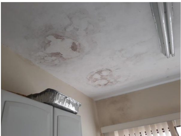
Infiltrações e mofo
