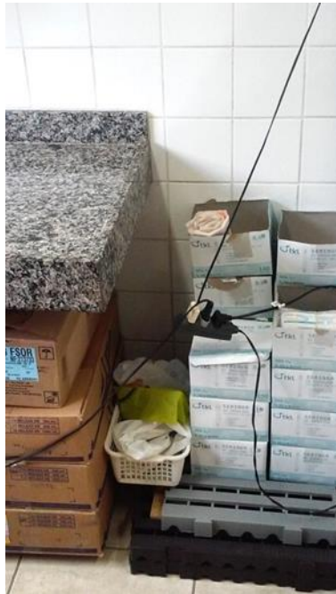
Uso de extensões e adaptadores para ligação de equipamentos elétricos
